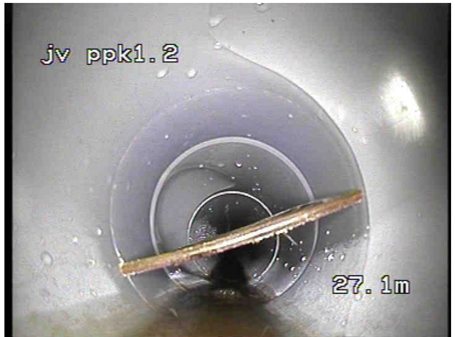
Kuva 1, 2. JV PPK 1.2, myötävirtaan, n. 27m kohdalla havaittu vanerin pala poikittain V110-viemärissä. Suositellaan vanerin poisto viemäristä.
